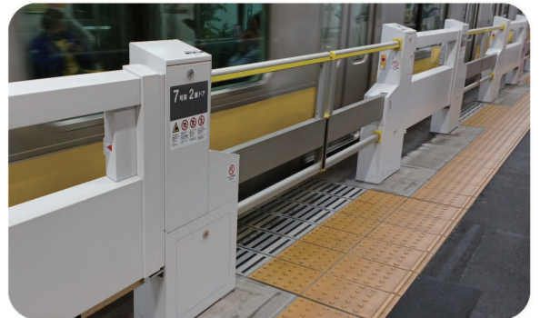
▲大久保駅に設置されているホームドア
